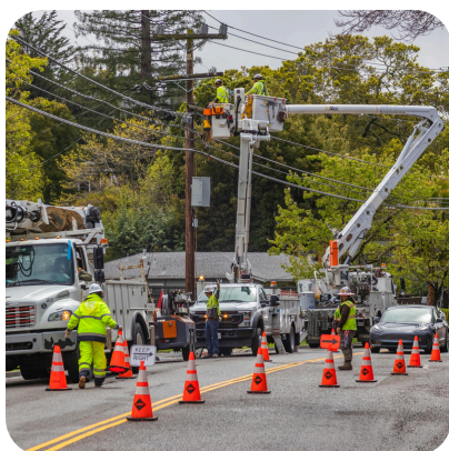
电力与通信维护
