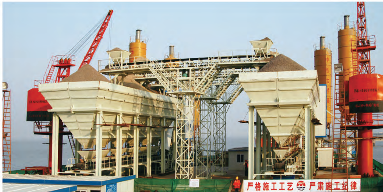
▲ 中铁大桥局水上平台特殊配料机
