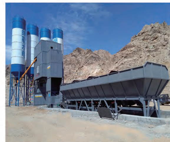
▲ 水工混凝土配料机
