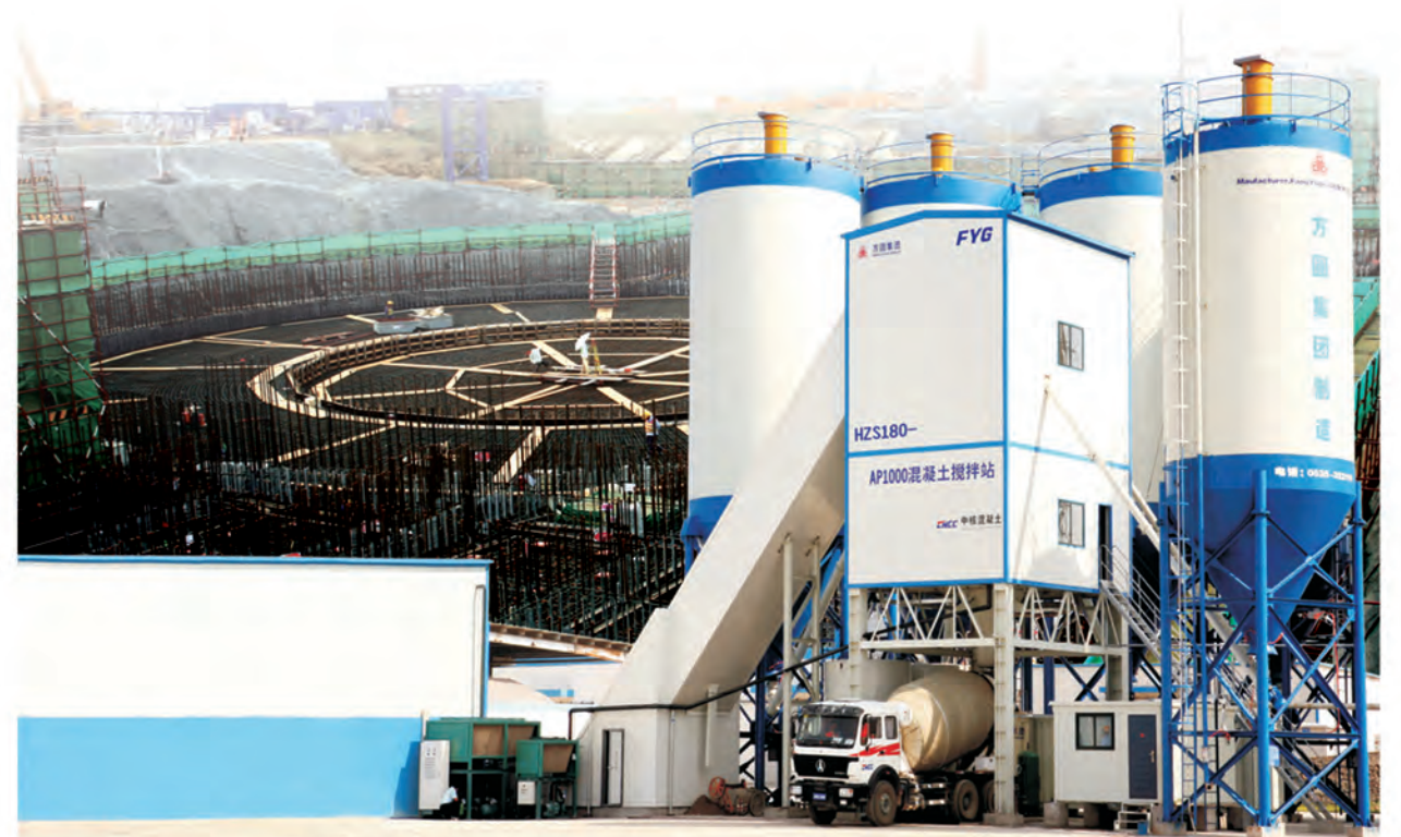
▲ 国内首台核电站建设专用混凝土搅拌站
