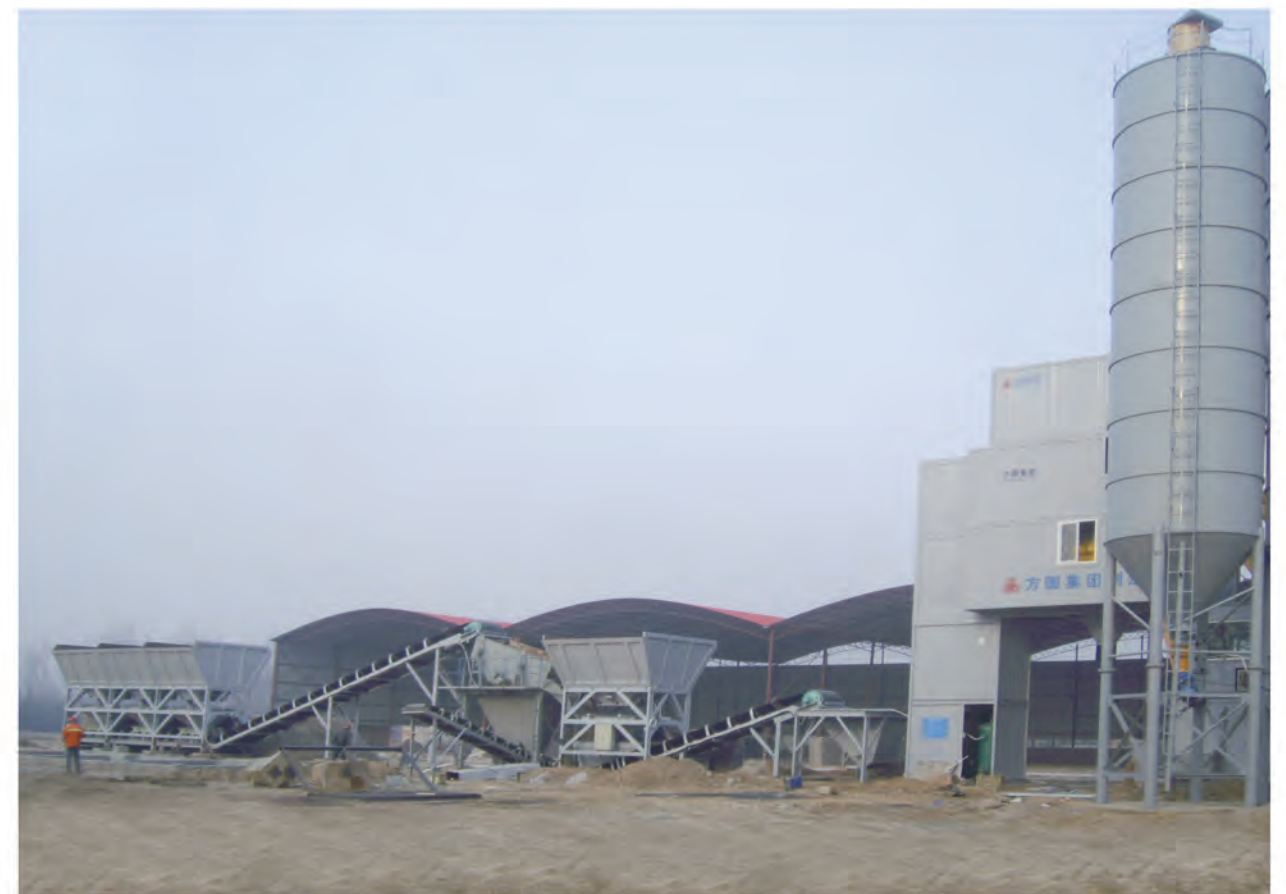
▲ 增加洗石机特殊设计搅拌站
