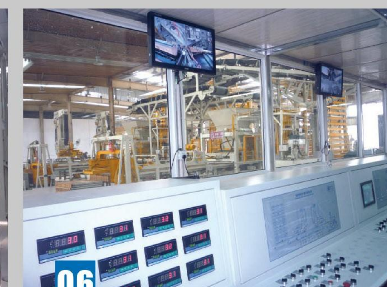
06 中央控制系统 PLC control system of the production line
