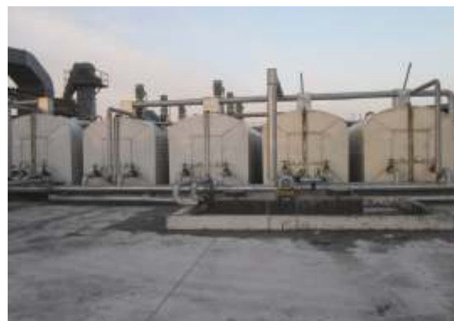
· 脱色沥青存储罐 ·
