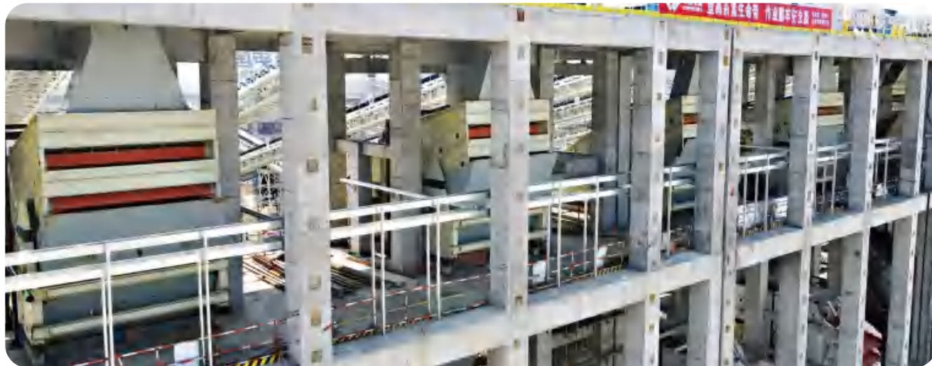
▲ 湖北中电建蕲春新材料有限公司现场 32000tph
