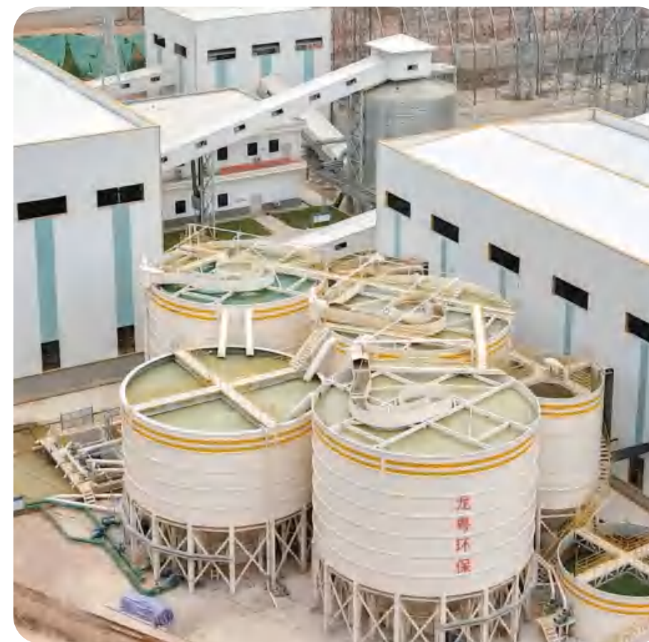
▲ 德庆润盛石场3000m 3 污水沉淀系统项目
