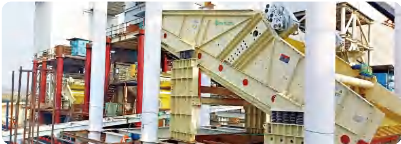
▲ 湖北中电建长峡二期陆域碎石水洗项目现场 6000tph
