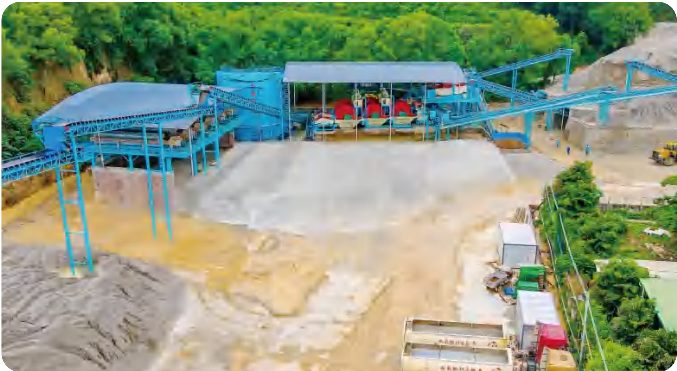
▲ 广东惠州600tph/EPC项目
