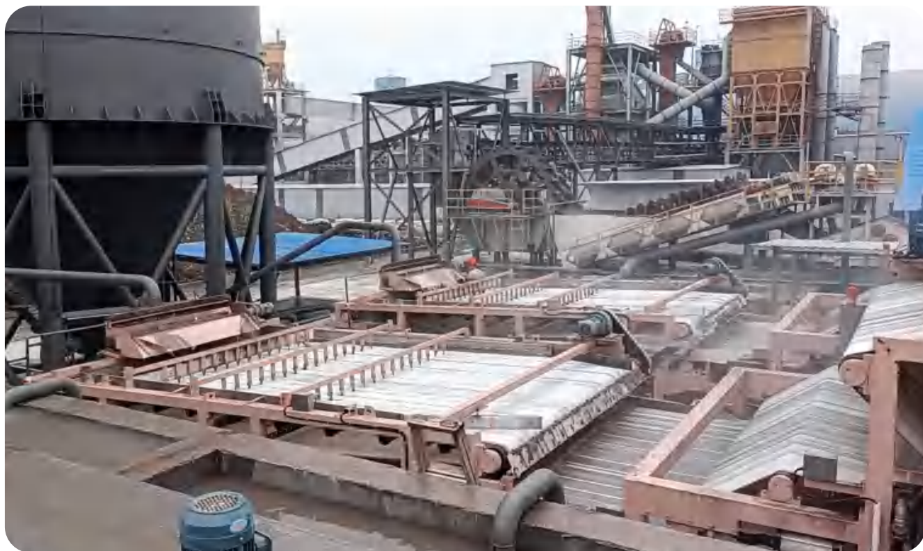
▲ 安徽马鞍山400m 3 污水沉淀系统项目
