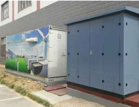
张家界经济开发区创业园光储项目 500kW/1000kWh 储能系统
