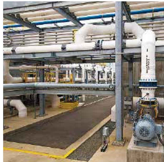
海水淡化 Seawater desalination
