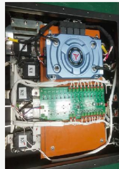
泵车混动高压配电系统
