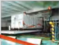
大型水平压缩 垃圾站配套
