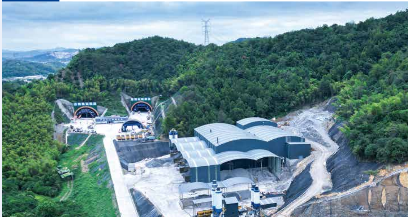
时产500吨洞渣加工破碎制砂项目
