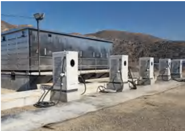
辽宁葫芦岛-单主机2.4MW+400kW一体机*6
