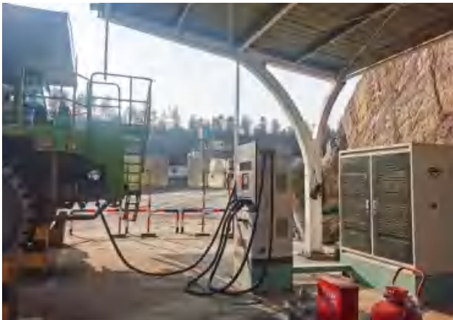
安徽滁州-900kW*2主机+三枪液冷充电桩*2
