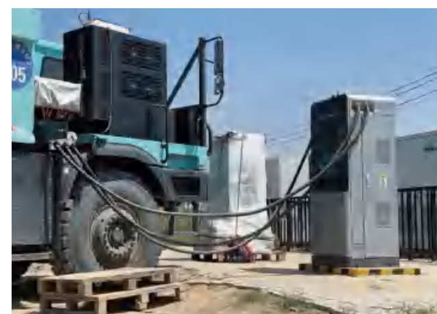
▲ 2022年国内首台1.8MW 3枪液冷充电项目 【内蒙古 鄂尔多斯】
