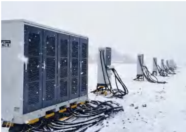
内蒙古锡林浩特-单主机2.4MW+1.92MW
