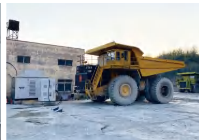
▲ 国内首台套单枪1500V 1500A矿卡充电项目 【辽宁 鞍山】
