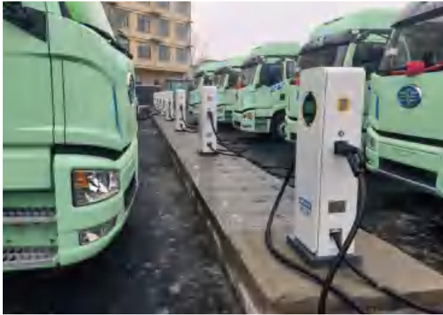
安徽阜阳-单主机2.88MW+2.4MW
