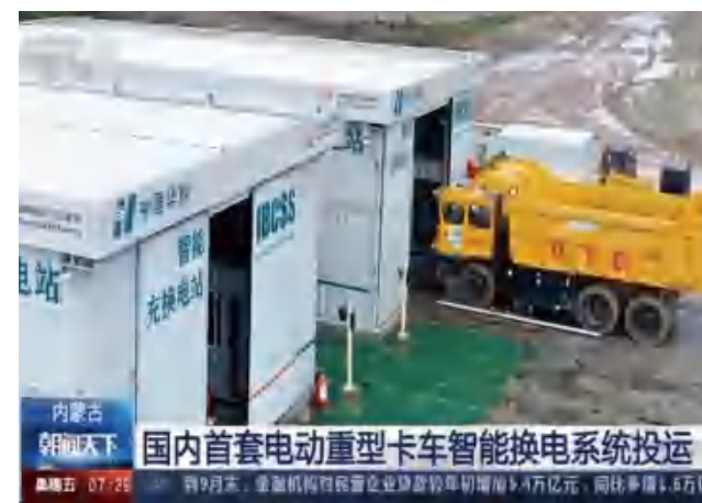
▲ 2019年国内首台套 电动矿卡充换电项目 【呼伦贝尔 鄂温克自治旗 伊敏镇】
