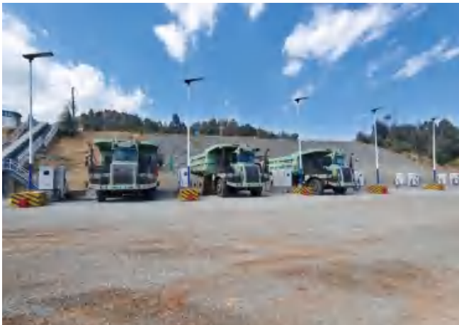
山东济南-320kW*11双枪一体机
