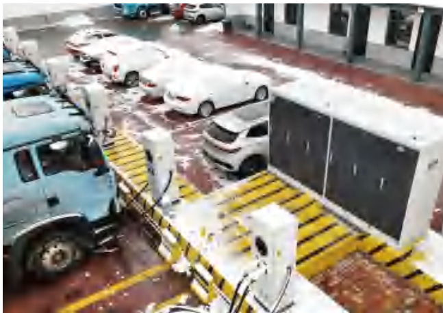
山东德州-单主机2.88MW
