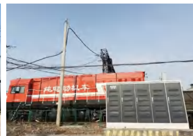
▲ 国内首台纯电动车 液冷超充项目【江西 新余】
