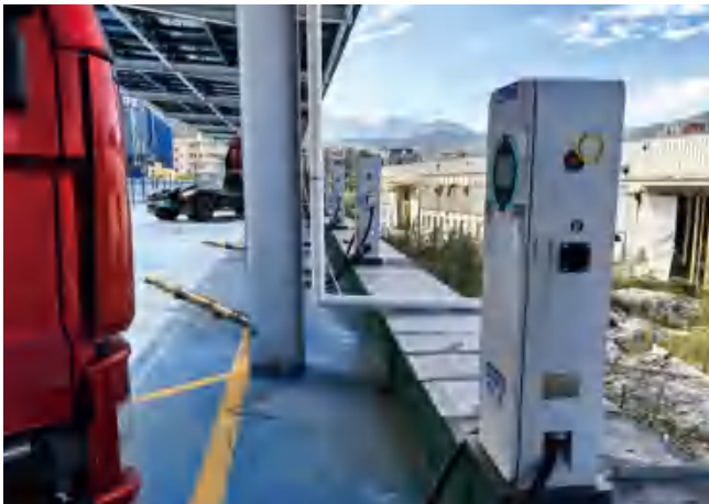
福建福清-单主机2.4MW+1.2MW
