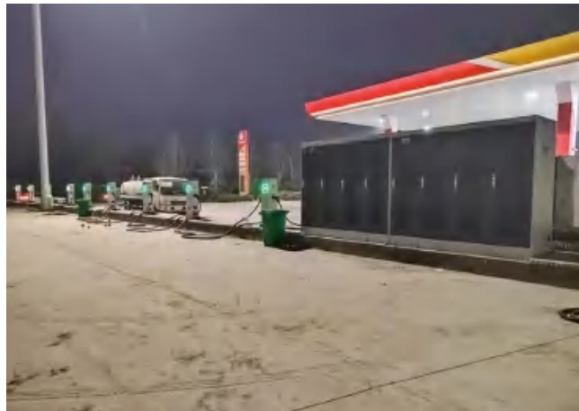
河南洛阳-单主机1.56MW*2
