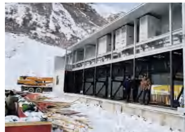
▲ 2021年世界海拔最高（海拔5200m）充换电项目 【西藏 昌都】
