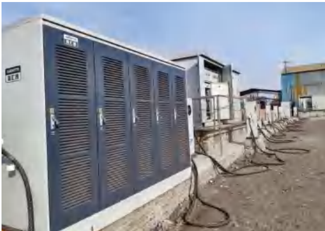
河北唐山-单主机2.4MW+1.92MW+1.6MW
