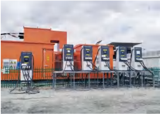
国内首台套单机4.5MW 无人驾驶矿卡充电项目【内蒙古 呼伦贝尔】
