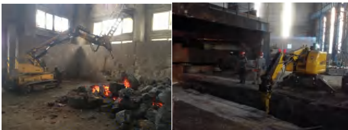
多功能机器人在马钢、金川等冶金行业的应用，机器人在高温、高粉尘、震动、强磁场等恶劣环境下稳定运行。
