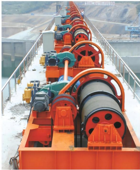
广西大埔水电站
