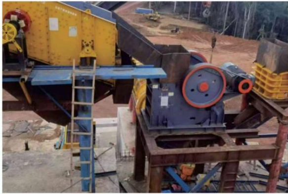
加蓬共和国 拉斯图维尔锰矿生产线 Manganese Ore Processing Line, Lastourville, Gabon
