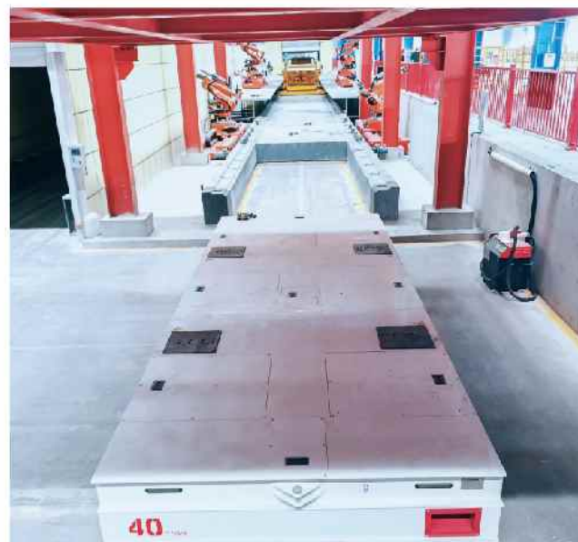
大型管片生产行业40吨智能管道生产总装线
