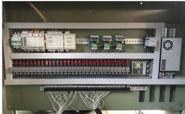
智能化控制系统 Intelligent control system
