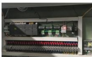
电控系统 Control system
