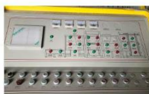
控制面板 Control panel
