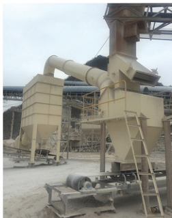
中水九局惠水公司重力惯性分级机干法制砂线
