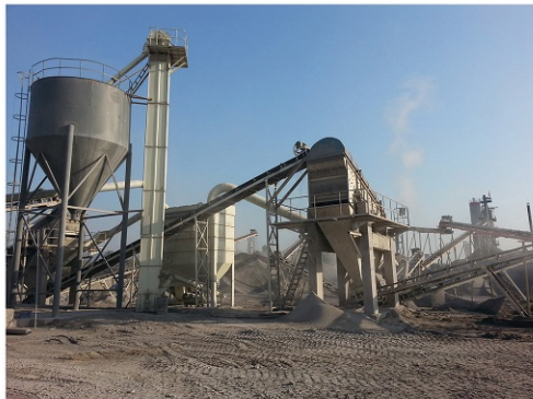
景德镇新越沥青除尘项目 Asphalt dust collector, Jingdezhen, China
