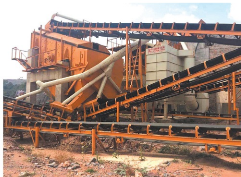
滁州市全椒县除尘工程 Chuzhou, Anhui, China
