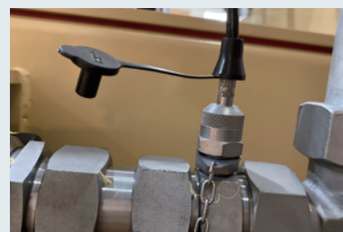
测压接头和测线
