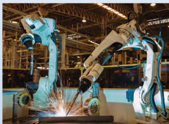
◆ 焊接机器人 Welding robot
