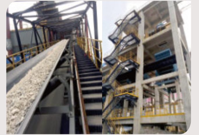
四川·都江堰-拉法基水泥500 t/h精品机制砂生产线
