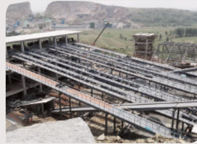
河南·驻马店-同力水泥1600 t/h生产线
