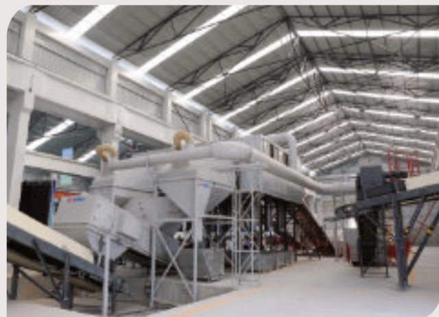
东莞盈新环保300 t/h建筑垃圾环保项目
