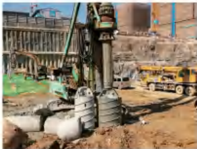
广州黄埔保利罗兰国际项目 Guangzhou Huangpu Poly Loran International Project
