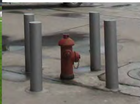
消防栓 Fire Hydrant
