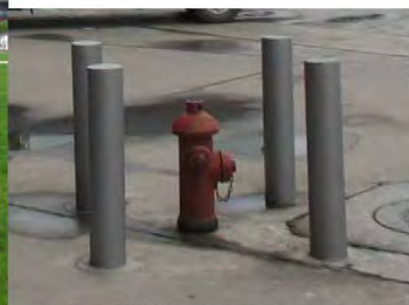
消防栓 Fire Hydrant
